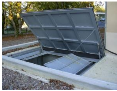
Trappe sur vérins hydrauliques (source Compte.R)
